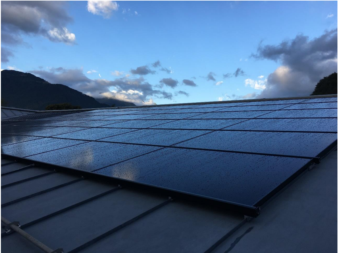
neue Photovoltaikanlage auf dem Dach des Gemeindezentrums
